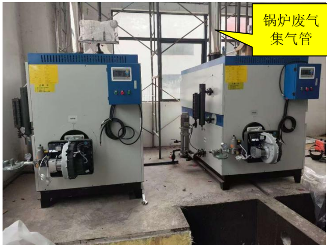
2台燃气蒸汽锅炉
