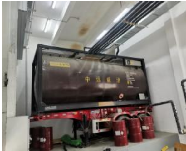
现有异氰酸酯储罐间
