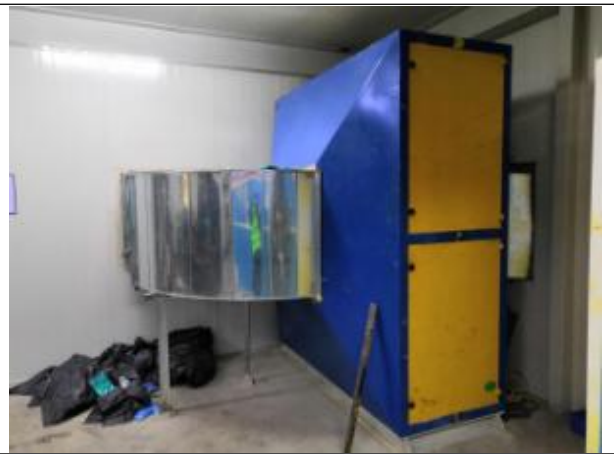
现有一级活性炭吸附装置
