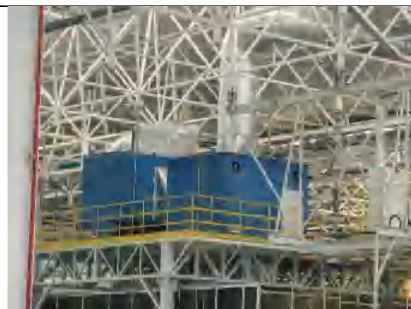
车身车间废气处理措施
