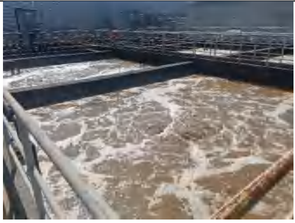
污水处理站水池
