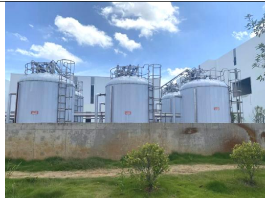
电解液罐区（已安装完成）
