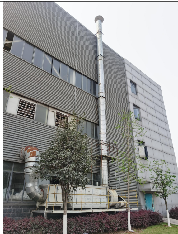
现有工程排气筒 DA001
