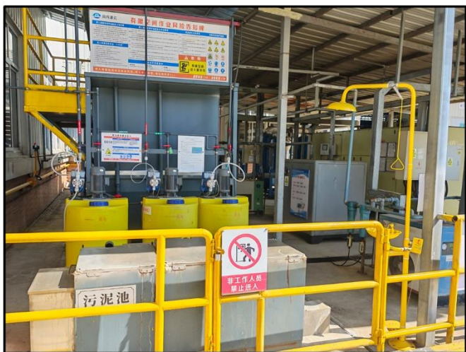
项目一体化污水处理站
