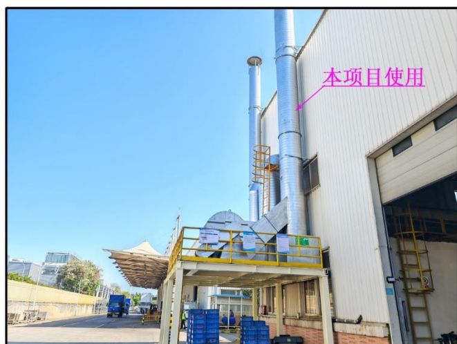
项目现有排气筒
