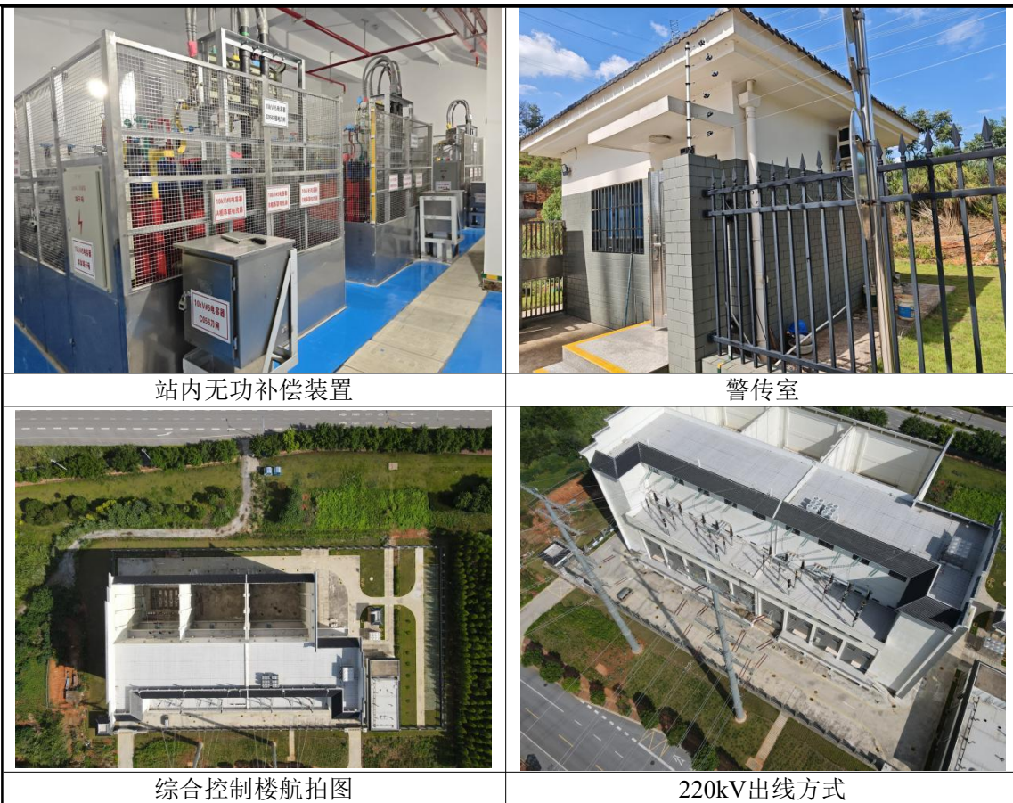
续图 2-1 220kV 满塘变电站站内建筑及电气布置情况现状照片
