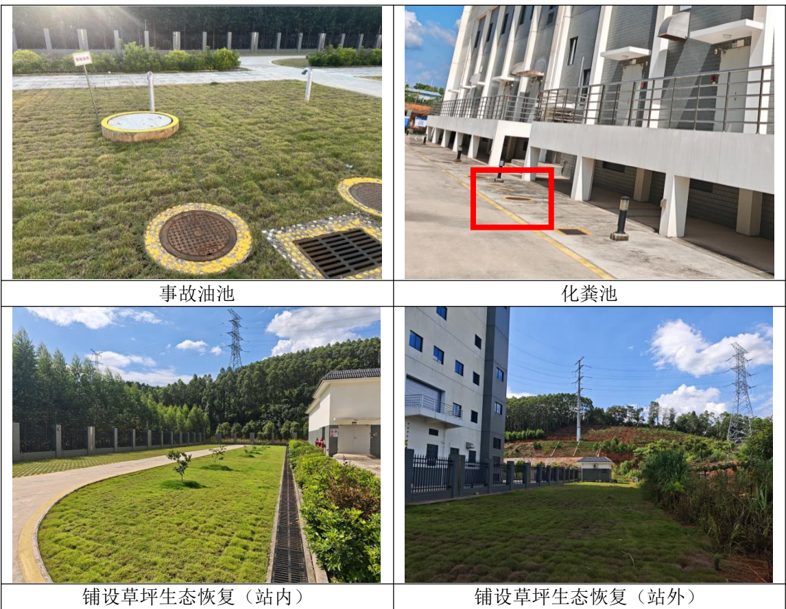
图2-2 220kV 满塘变电站内环保设施现场照片
