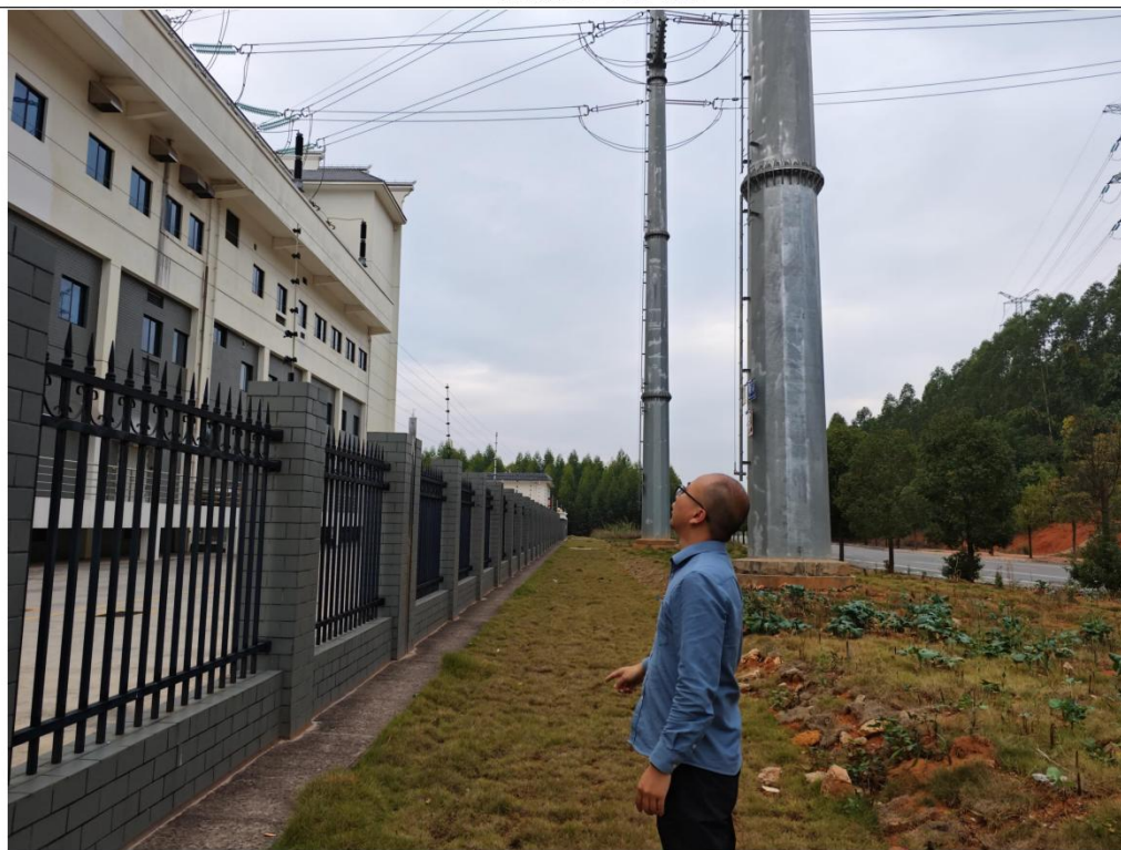
220kV 满塘变电站 220kV 出线侧
