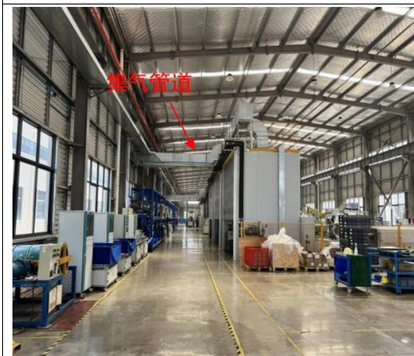
现有脱模废气收集管道
