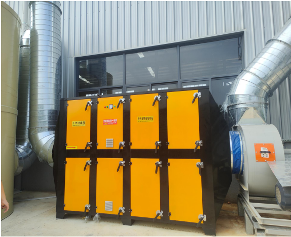
有机废气处理装置
