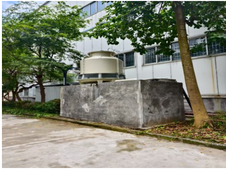
循环冷却系统
